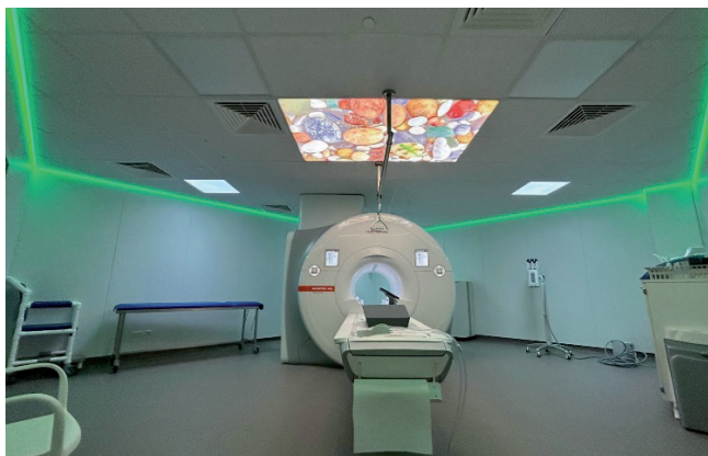
Ledverlichting in de MRI-ruimte
